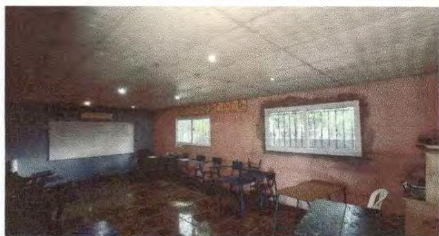
Foto 7: Pintura interior de aulas
